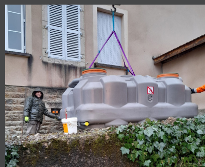
Assainissement de la mairie de Lains
