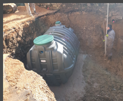
Assainissement à Montagna
